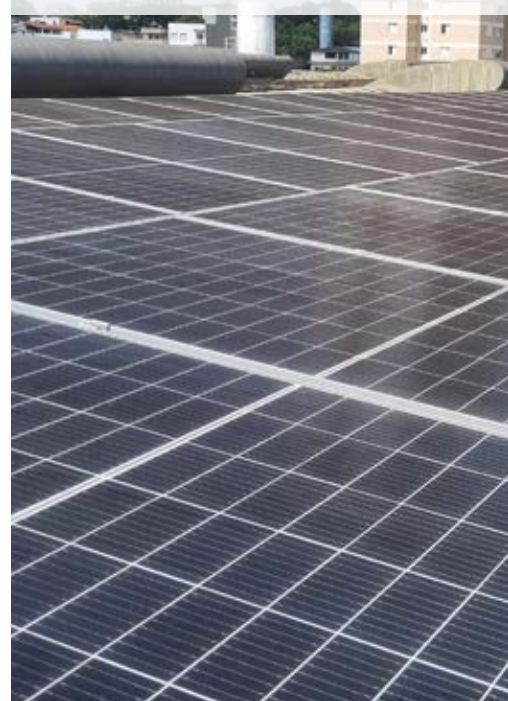
Energia Limpa - Fazenda Solar, Business Park Diadema
